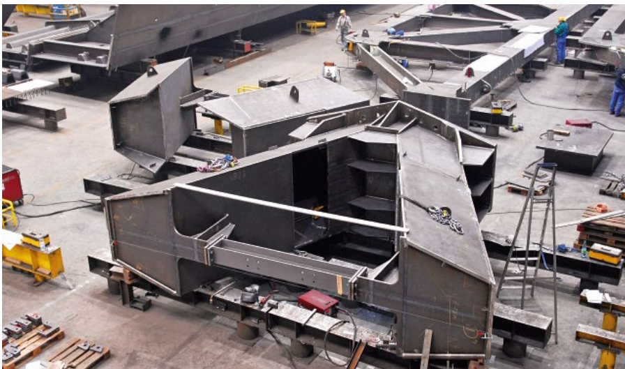
Bild 9. Vorfertigung/Vormontage Pfeilerstreben mit Verankerungspunkt (Foto: 2013 Donges Steeltec GmbH) Fig. 9. Pre-assembly of the pillar-area
