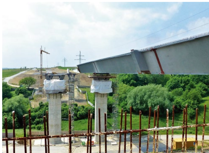
Bild 15. Ende Längsverschub 1. Takt (Foto: 2013 Donges Steeltec GmbH) Fig. 15. End of longitudinal lifting
